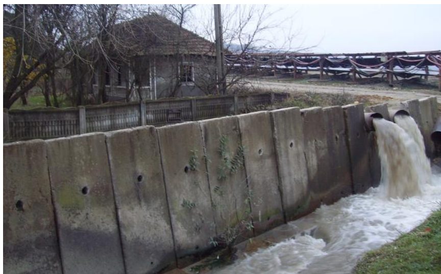
Fig.1. Apă uzată evacuată în canalul de gardă al carierelor Jilț
